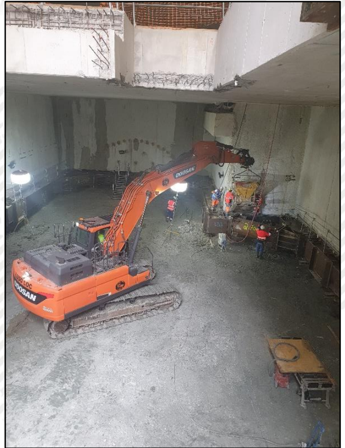
Suite de l'excavation après le coulage des parois et bétonnage de la première dalle
